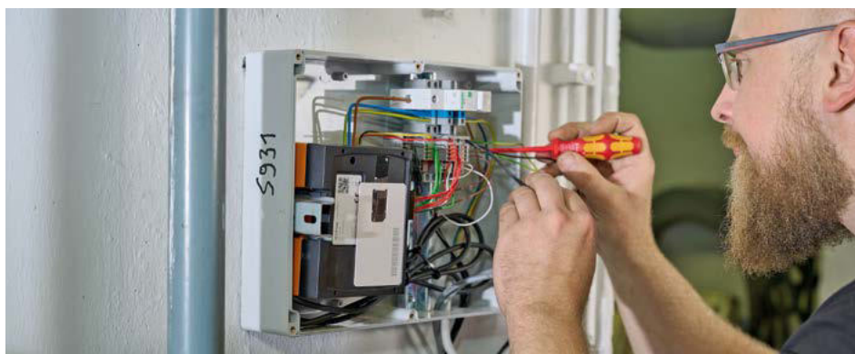
Nach der Installation einer intelligenten Heizungsüberwachung werden Betriebs- und Verbrauchsdaten aus dem Heizungskeller kontinuierlich erfasst, analysiert und dokumentiert.
