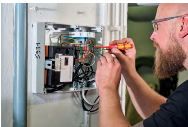
Die digitale Nachrüstung erfolgt durch das Fachpersonal des Monitoring-Anbieters ohne Betriebsunterbrechung Alle Fotos © Immoconn
